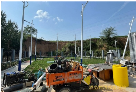
酒务村污水处理厂站
